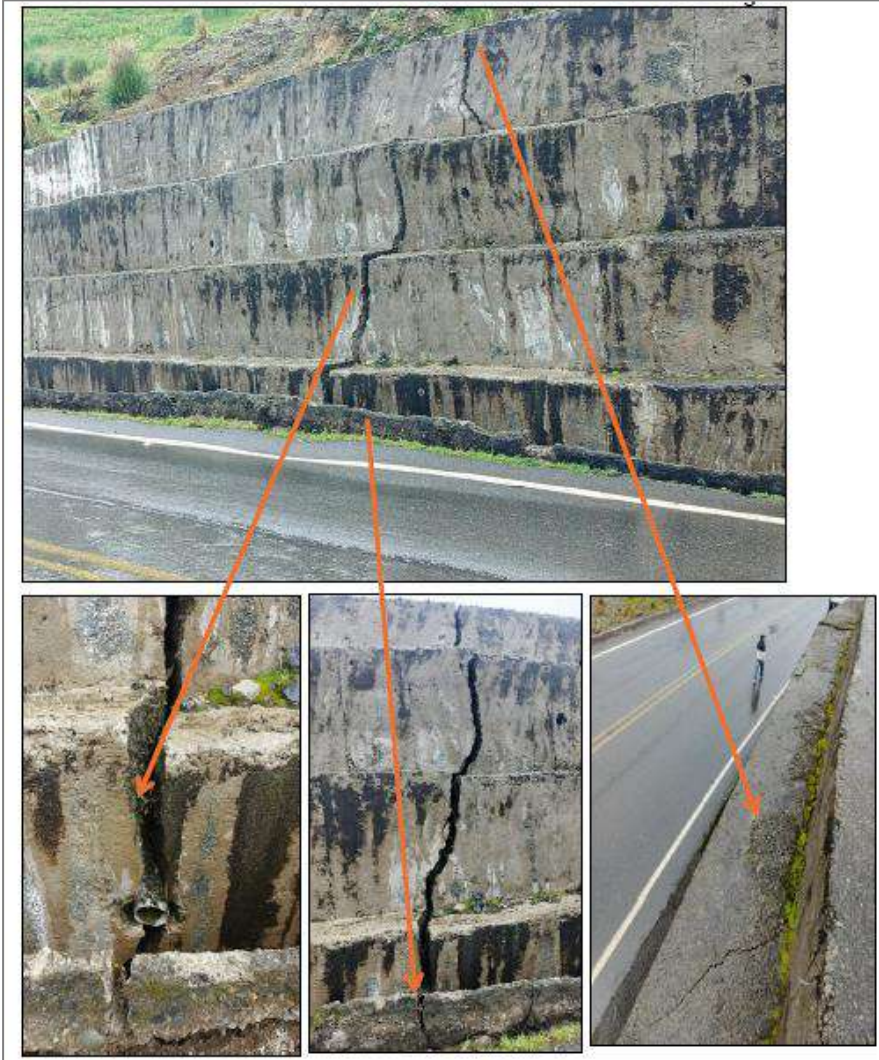
Agrietamientos de muros de contención
